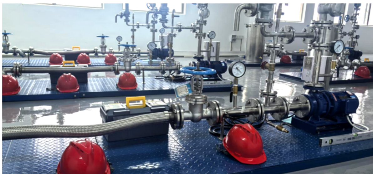
图 2-6-4 化工综合拆装实训室
